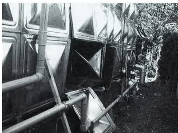
受水槽の破損 (中越地震・長岡市)
