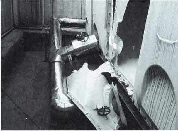
受水槽の被害（中越沖地震・柏崎市）
