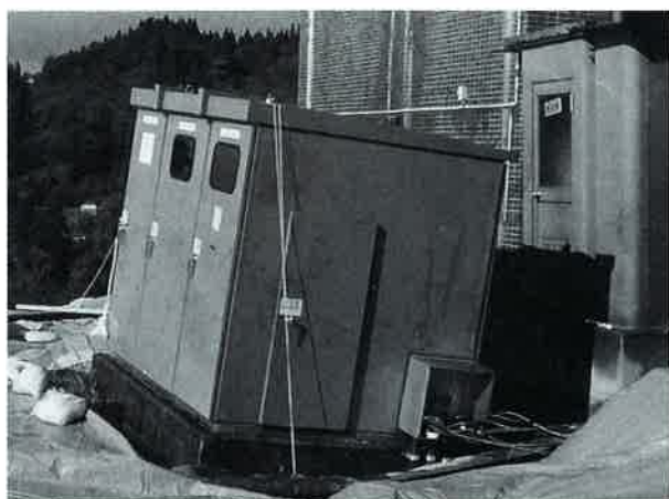
キュービクルの被害 (中越地震・長岡市)
