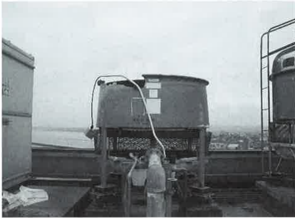
クーリングタワーの被害（中越沖地震・柏崎市）
