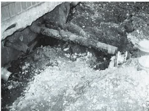
給水管の破断（中越沖地震・柏崎市）
