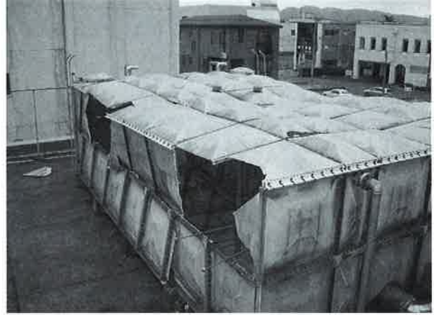
受水槽の被害（中越沖地震・柏崎市）
