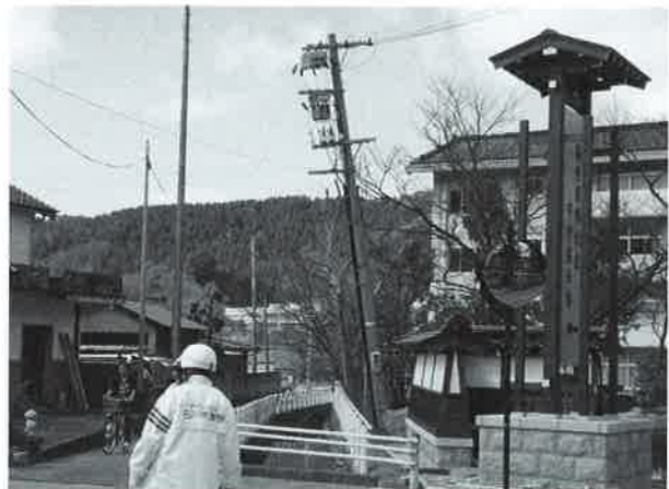
電柱の傾斜（能登半島地震・門前町）
