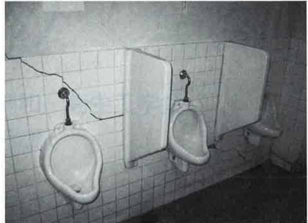
トイレの被害（中越沖地震・柏崎市）
