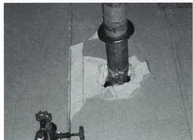
壁貫通部の被害（中越沖地震・柏崎市）
