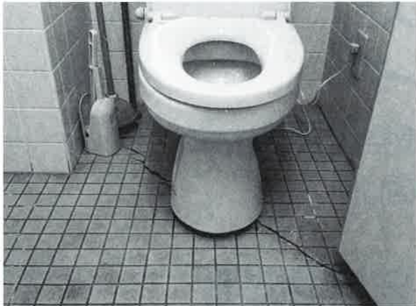
トイレの被害（中越沖地震・柏崎市）
