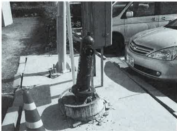
消火栓周りの破損（中越沖地震・刈羽村）
