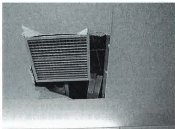
天板の破損 (中越地震・小千谷市)
