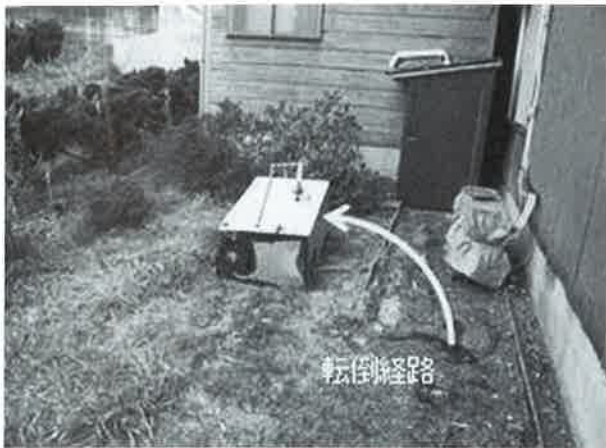
給湯器の転倒被害（能登半島地震・輪島市）
