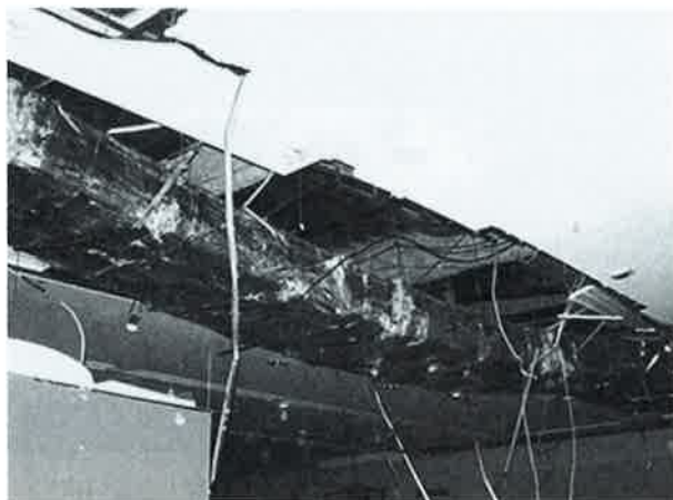
脱落したダクト (中越地震・小千谷市)
