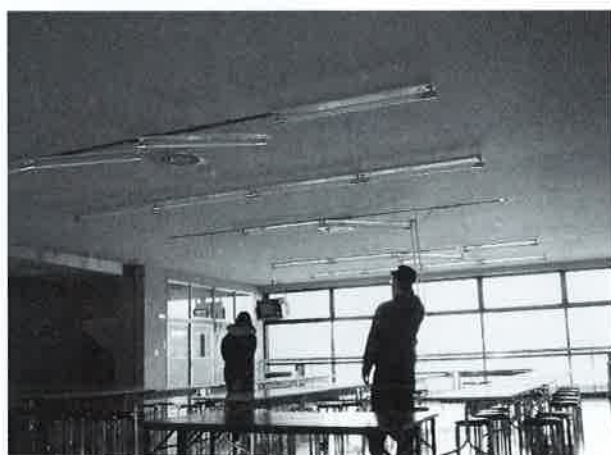
蛍光灯の脱落（能登半島地震・穴水町）
