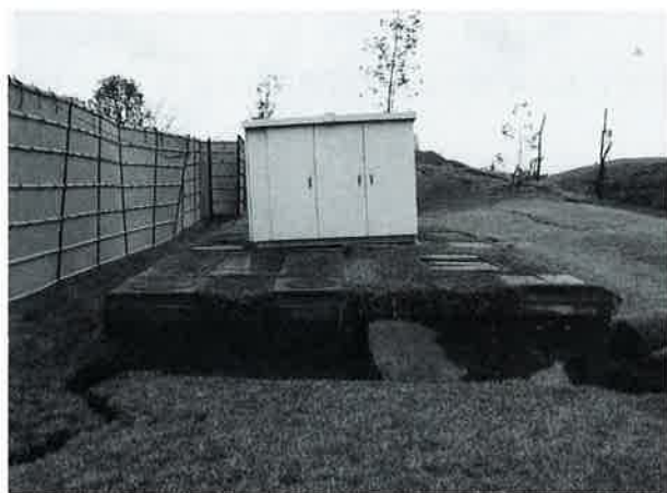
浄化槽の浮き上がり (中越地震・長岡市)
