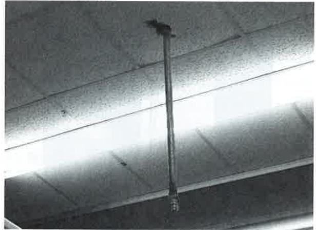
スプリンクラーの脱落（中越地震・長岡市）
