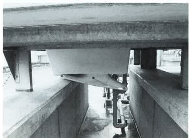
クーリングタワーの被害（中越沖地震・長岡市）
