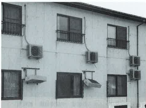
室外機の転倒（中越沖地震・刈羽村）
