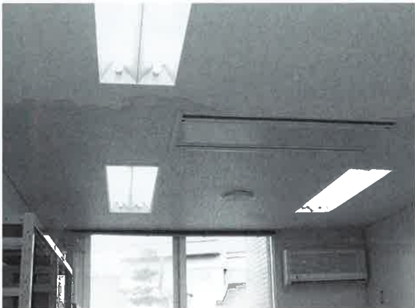
配管の破損と漏水被害（中越沖地震・柏崎市）
