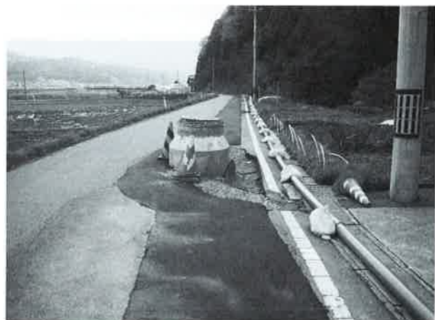
マンホールの浮き上がり被害（能登半島地震・門前町）
