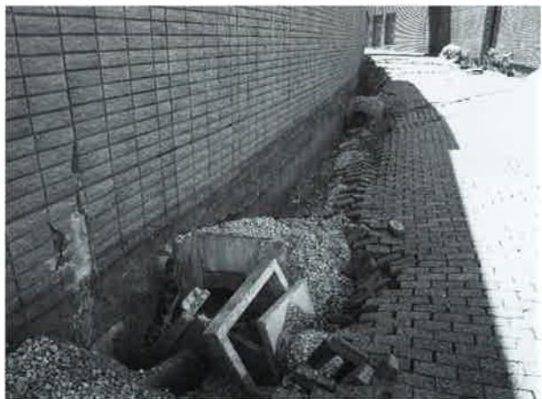
コンクリートマスの破壊（中越沖地震・柏崎市）
