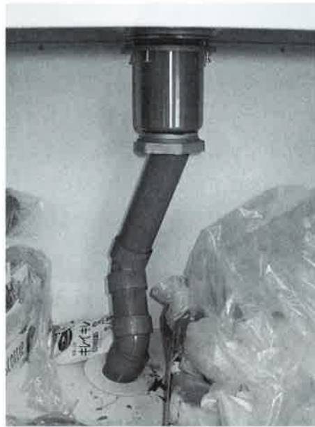
排水管の漏水（中越沖地震・柏崎市）
