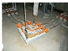
Hシステム オイル配管 3本組み 地震後の設置状況 特に異常なし ※地みは施工当時のもの
