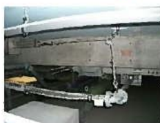
Hシステム 消火配管 地震後の設置状況 特に異常なし
