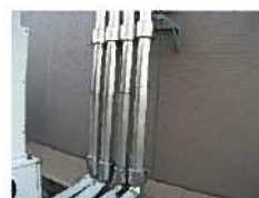
Vシステム 屋外設置空調配管 地震後の設置状況 特に異常なし
