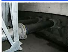
Fシステム 排水配管 地震後の設置状況 特に異常なし
