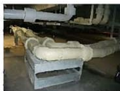
Cシステム 冷温水配管 2本組み 地震後の設置状況 漏水、変形などに異常なし
