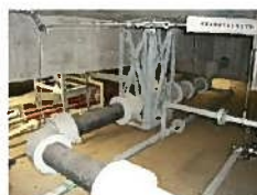
Hシステム 給水配管 地震後の設置状況 特に異常なし
